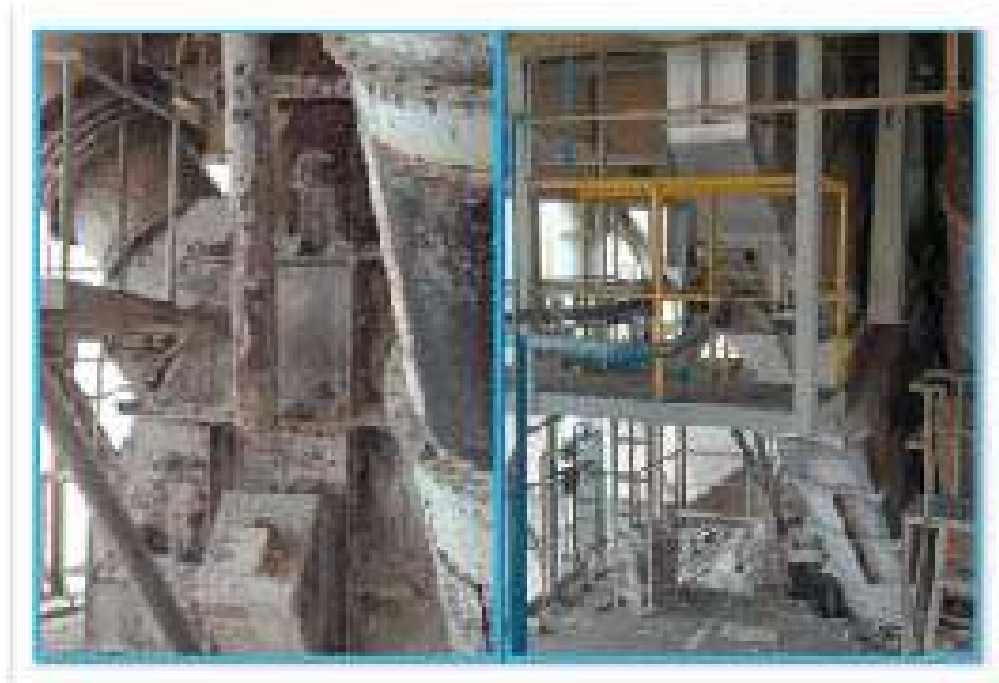
Gambar 3. Kiln Inlet Sebelum dan Sesudah Pemasangan Fasilitas Pemanfaatan
